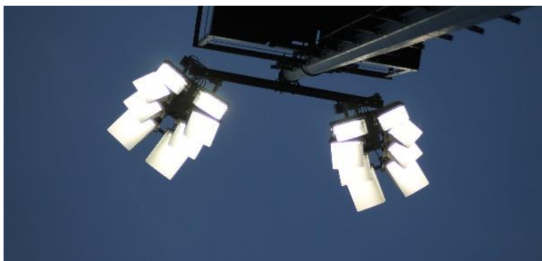
Die neue LED-Flutlichtanlage
